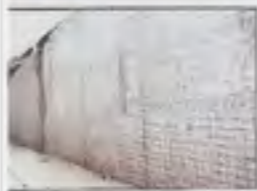
La superficie lavorata dalla Sika SpA e rivestita con rete elettrosaldata maglia 30x30, preparata per essere ricoperta con una massa di malta speciale cementizia
