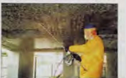
Un operatore con una speciale lampada mobile ispeziona la superficie dell'impalcato del viadotto
